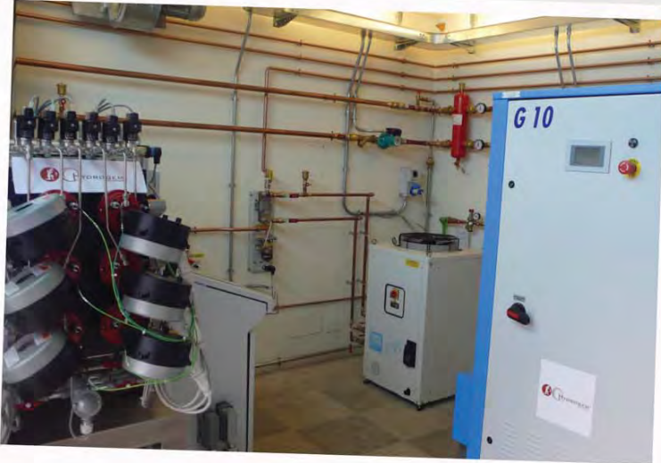
Hotel San Rocco Orta - 2010 Centrale termica a Idrogeno
