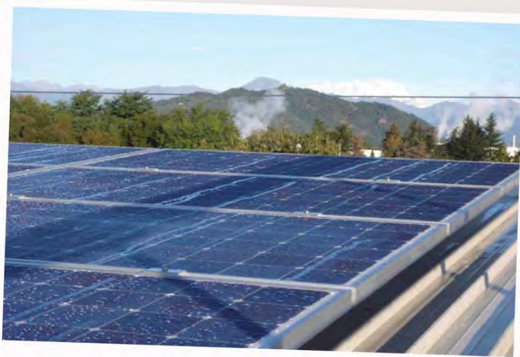
Romagnano - 2010 Loro Piana - 100kWp
