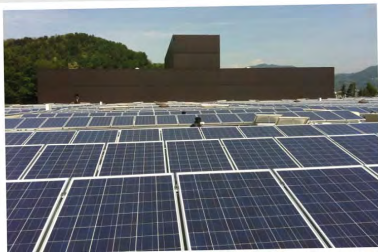
Parco Gessi - 2010 1500kWp - Collaudo
