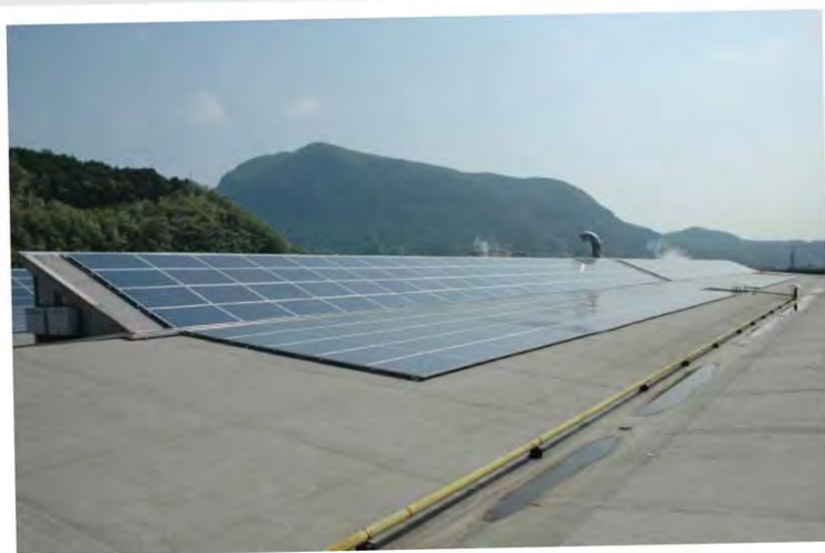
Borgosesia - 2011 Lanificio Colombo - 200kWp
